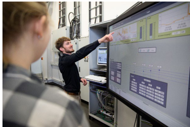
Die Steuerung und das Monitoring des Microgrid Labors erfolgt über einen Microgrid Controller
